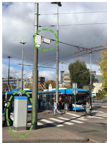
Laden vanuit de bovenleiding in Oosterbeek
