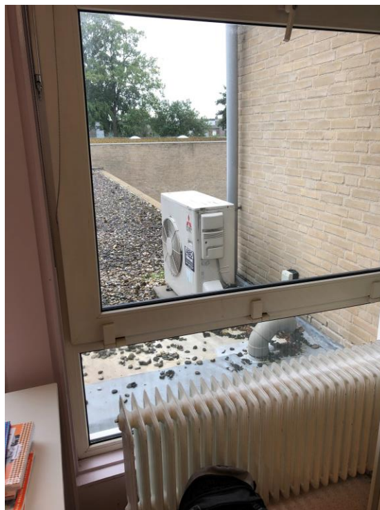
Airco t.b.v. serverruimte
